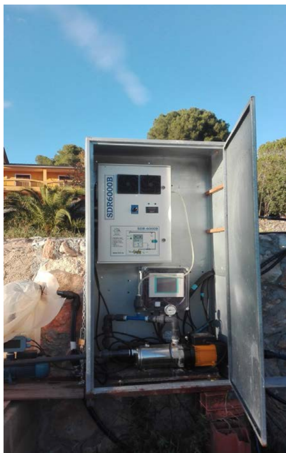
Desinfección de agua con OZONO Vs CLORO
